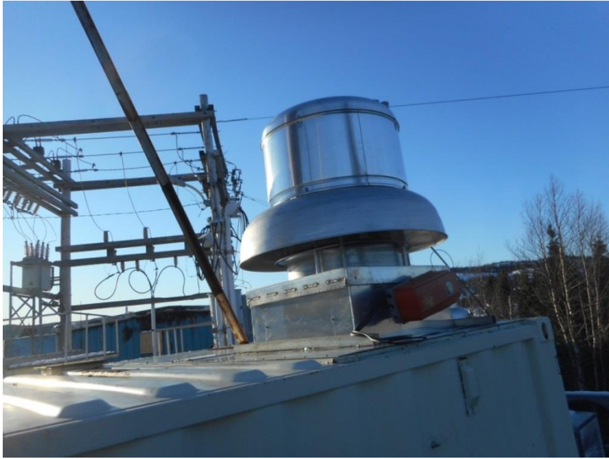
Photo 13: Unit 2088 Ventilation Fan
